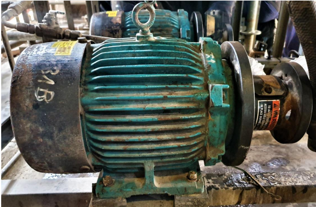
Slika 3-6 Elektromotor hidrauličkog agregata
