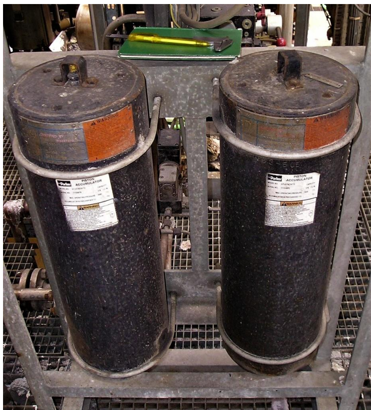
Slika 3-10 Hidraulički akumulatori unutar hidrauličkih jedinica
