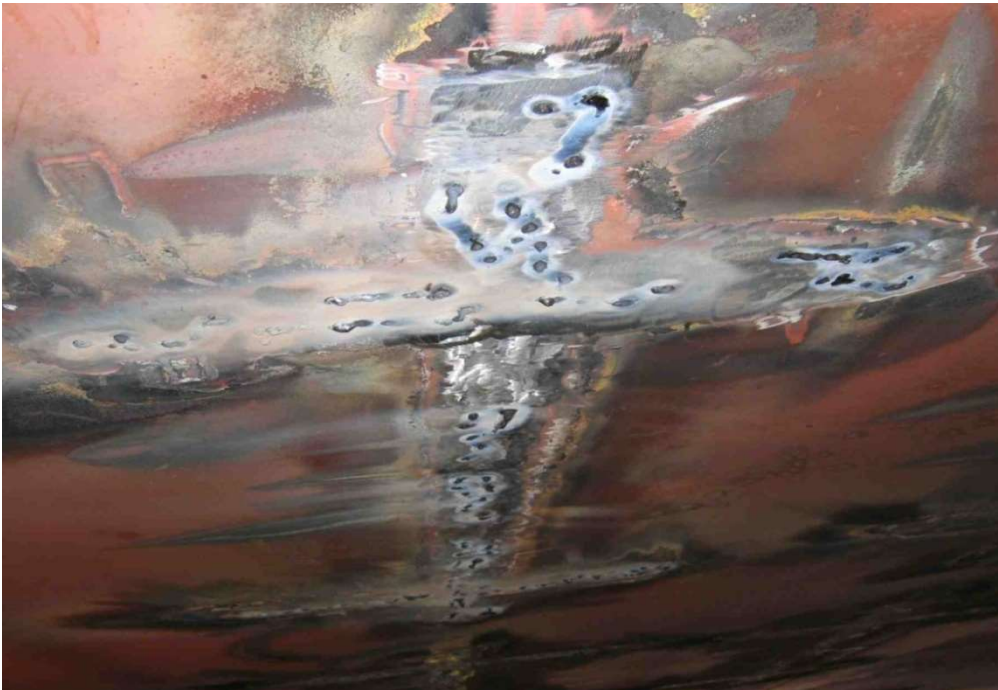
Slika 2-9. Izgled oštećenja popravljenih zavarivanjem. Izvor: autor
