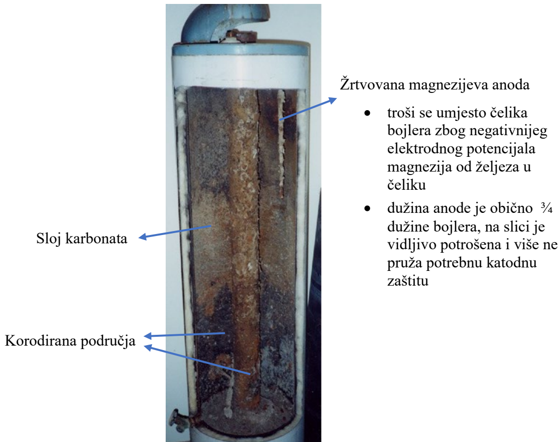
Slika 4.17. Korozija unutrašnjosti plinskog bojlera
