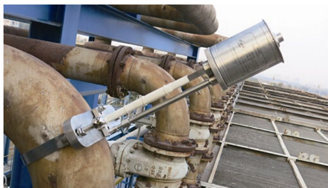
Slika 4.26. Mrežno ultrazvučno ispitivanje korozije na koljenu cjevovoda [39]
