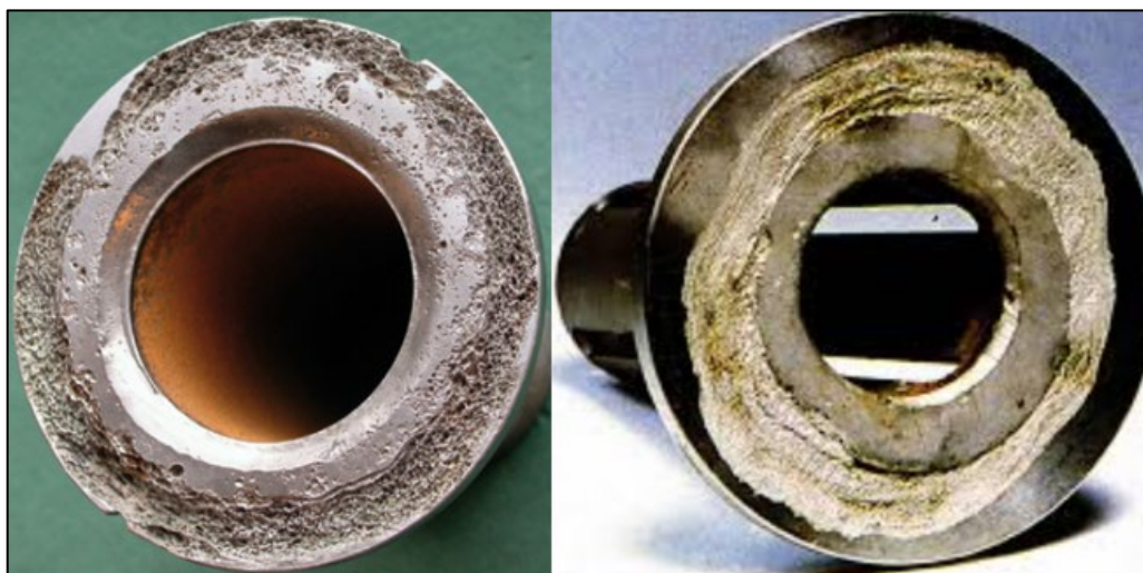
Slika 5.7. Korozija prirubnica s brtvom [43]
