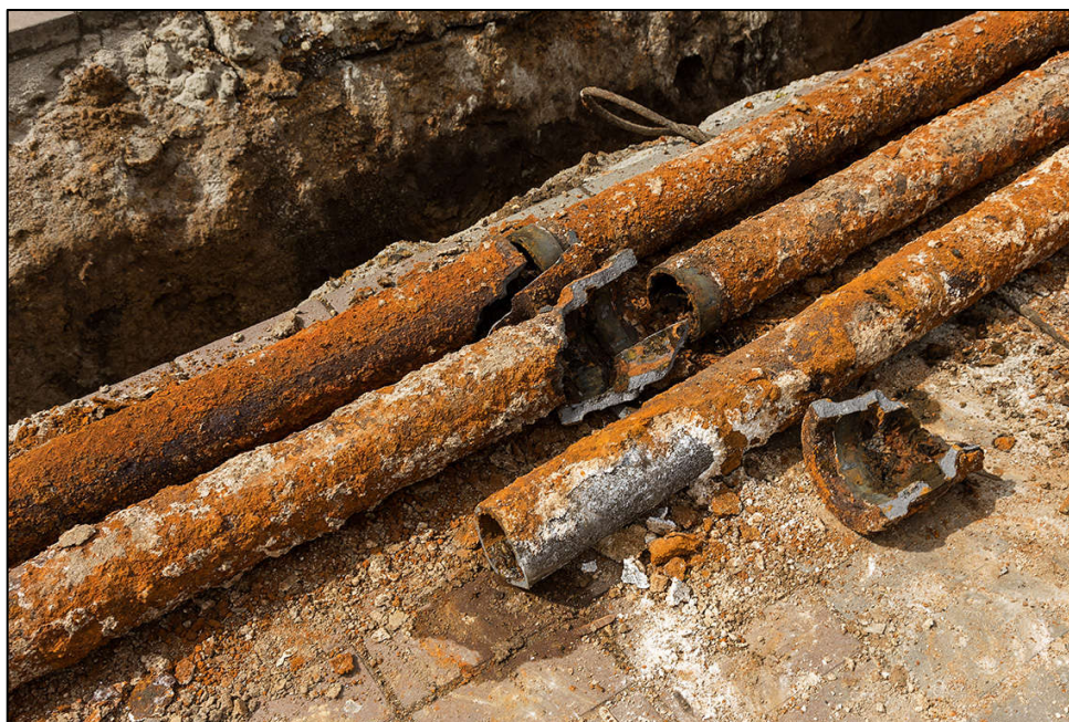
Slika 4.18. Korodirana vodovodna cijev od lijevanog željeza
