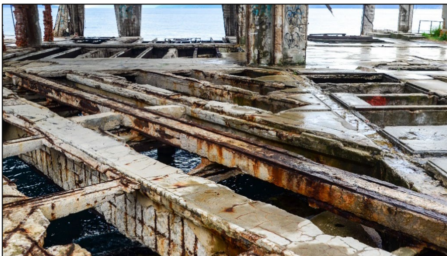
Slika 4.7. Korozija konstrukcije lansirne stanice Torpedo u morskoj atmosferi
