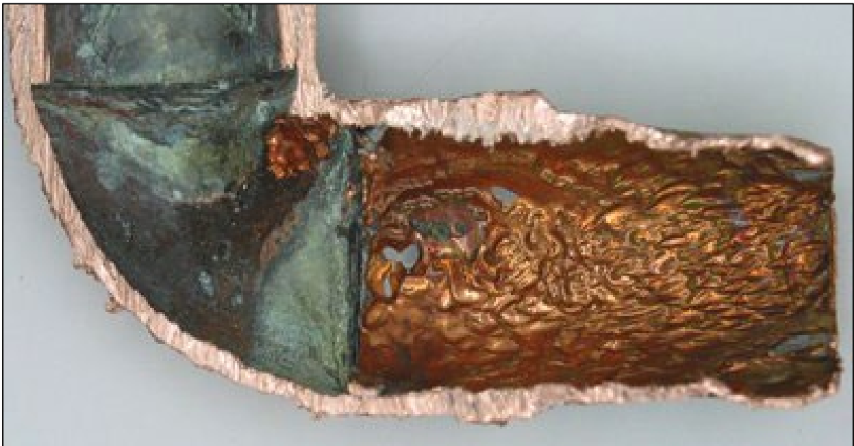
Slika 5.19. Erozijska korozija bakrene cijevi [51]
