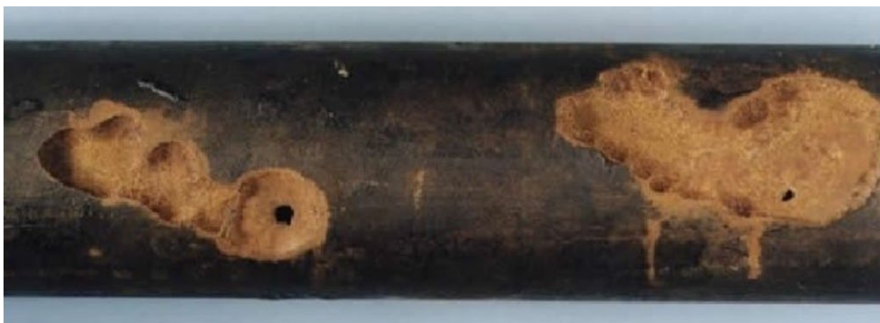
Slika 5.29. Tipičan primjer korozije lutajućih struja [60]
