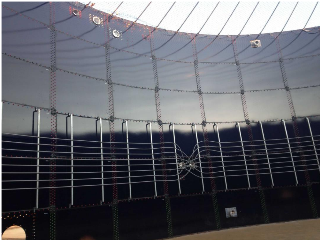
Slika 6.9 Grijaće cijevi u digestoru [30]
