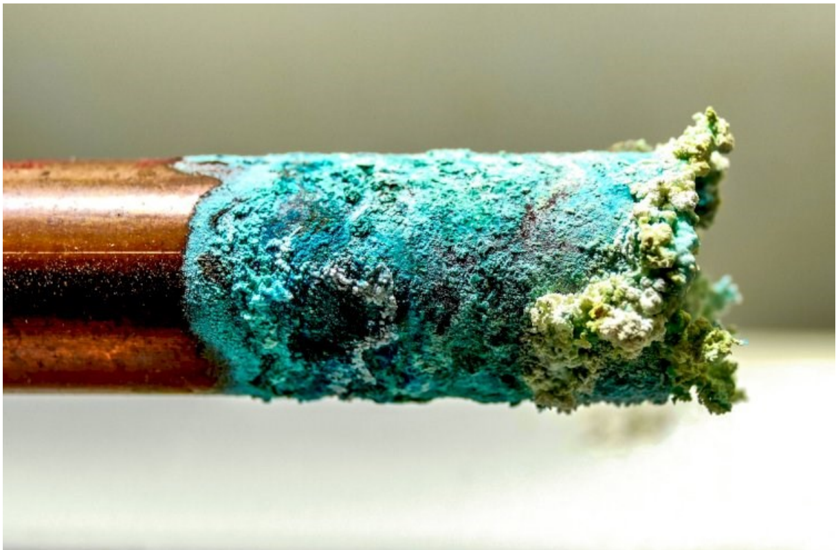
Slika 2.8. Korozija bakrene cijevi [12]
