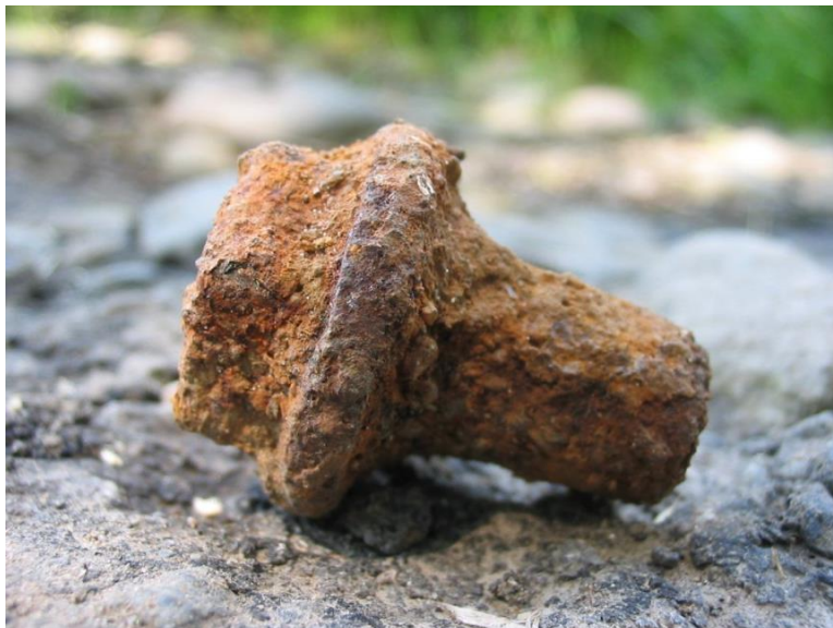
Slika 3.3. Neravnomjerna opća korozija vijka [23]
