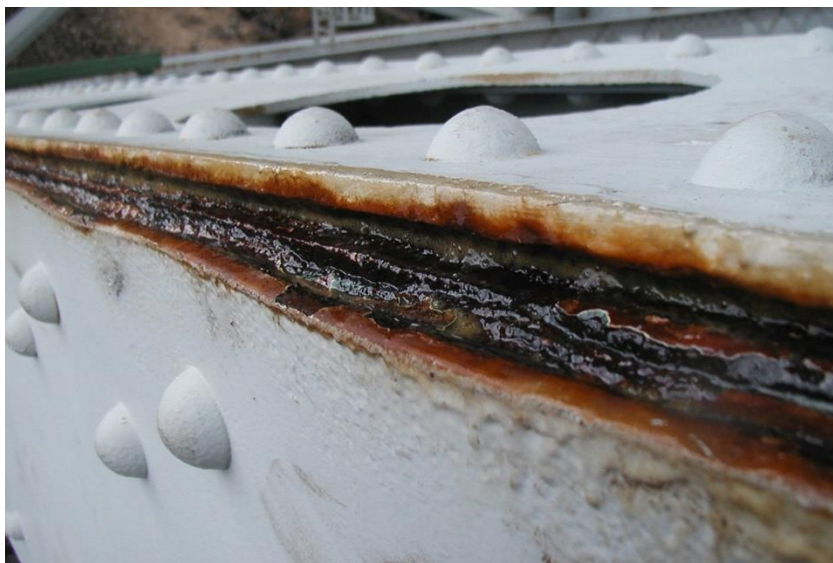
Slika 3.10. Korozija u procijepu na spoju dva metalna dijela konstrukcije
