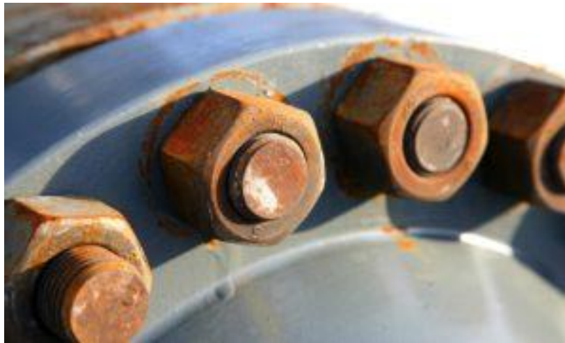
Slika 3.9. Galvanska korozija vijčanog spoja s prirubnicom
