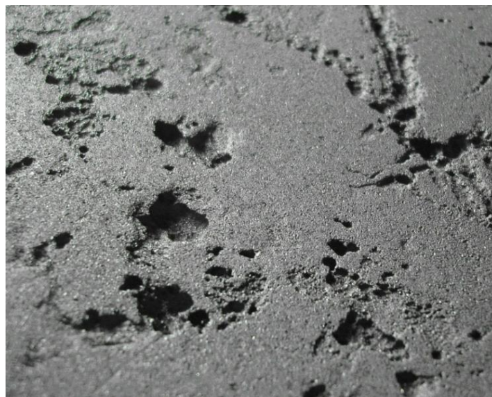
Slika 3.5. Rupičasta korozija (pitting) [24]
