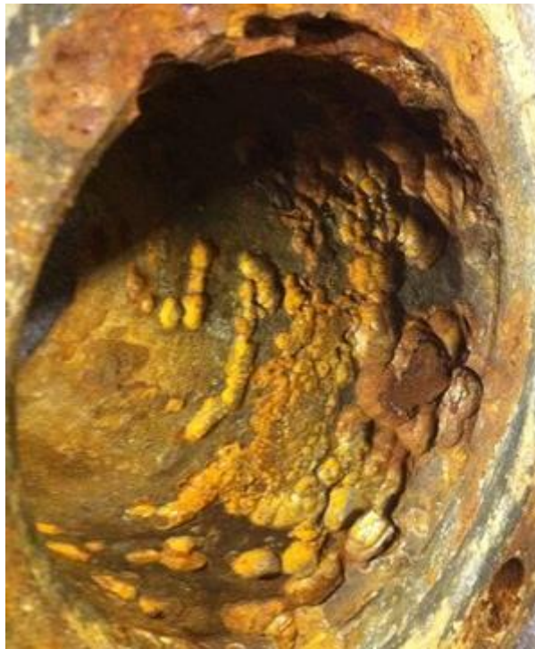
Slika 3.15. Posljedice djelovanja bakterijske korozije na unutrašnjost cijevi [35]
