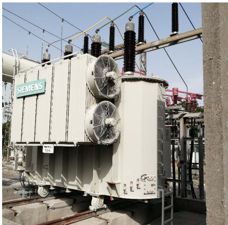
Slika 2.4. Transformator sa sustavom za prisilno hlađenje ulja zrakom
