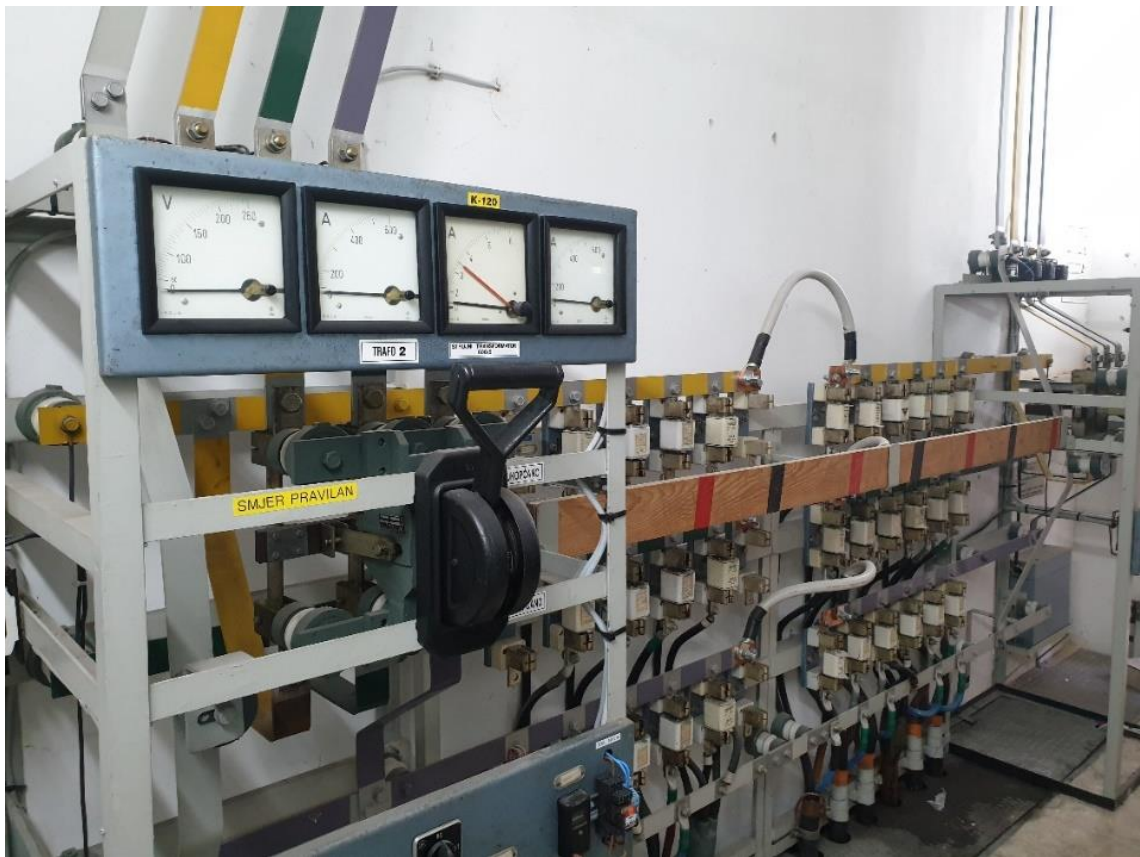
Slika 5.5. Stara izvedba NN bloka u TS Omladinska.
