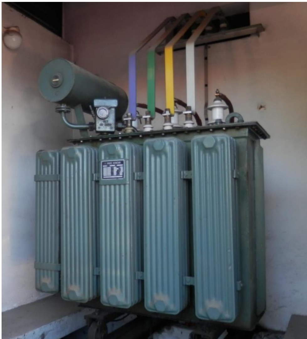
Slika 5.7. Stara izvedba transformatora snage 400 kVA.
