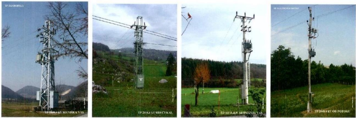
Slika 4.3. Prikaz „stupnih“ transformatorskih stanica. Izvor: [7]
