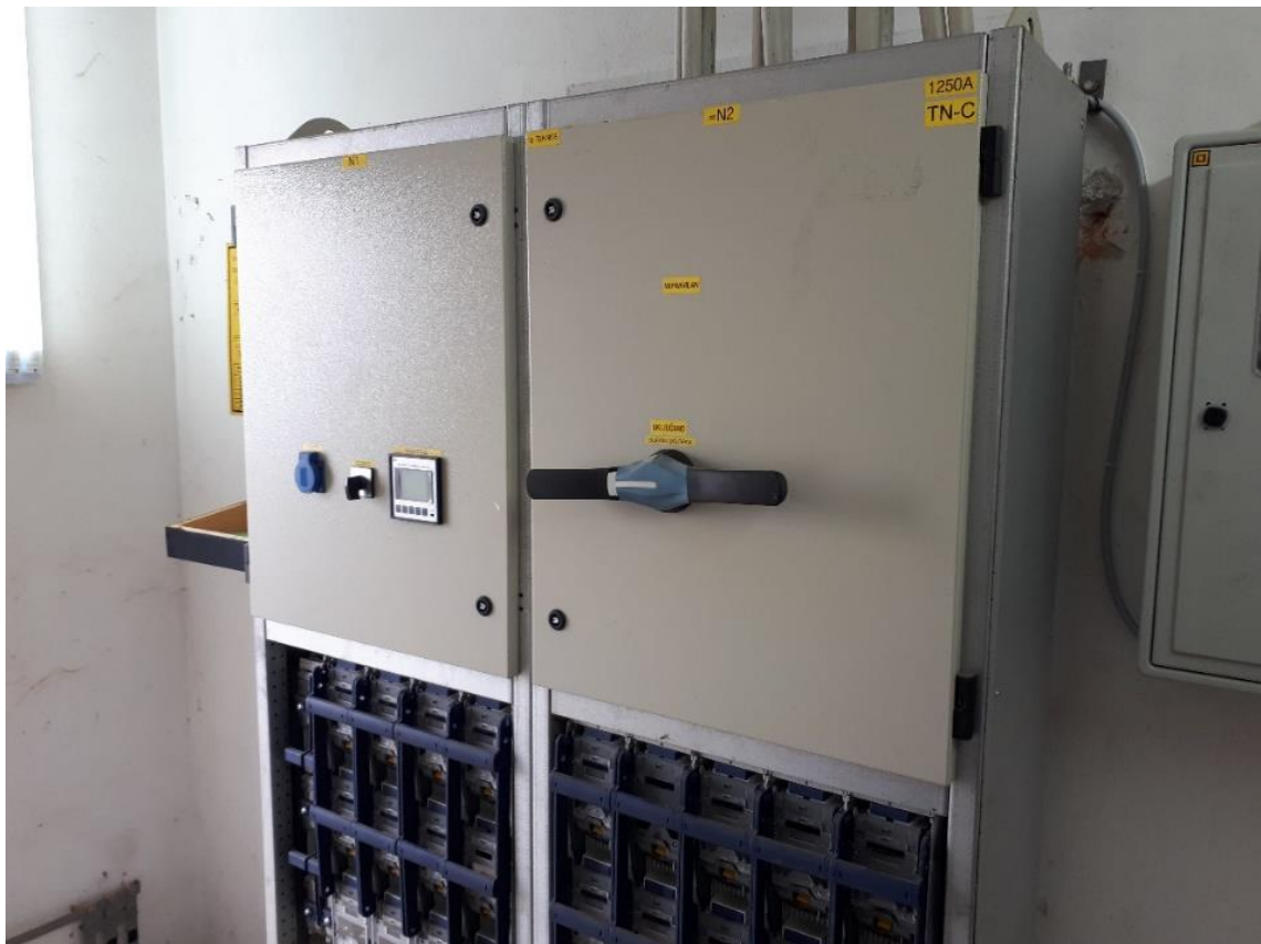
Slika 5.6. Nova izvedba NN bloka u TS Pehlin 5.
