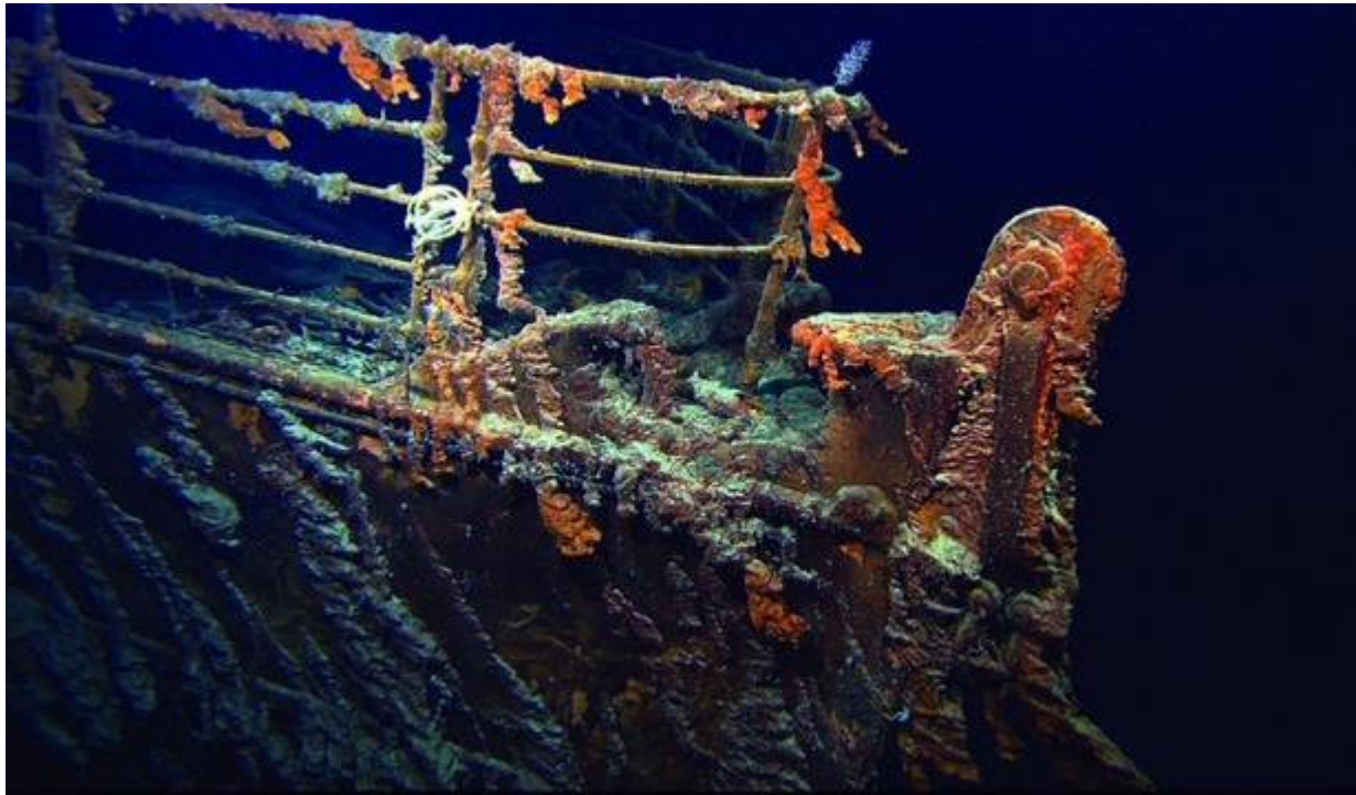
Slika 5.17. Biološka korozija – Titanik [38]
