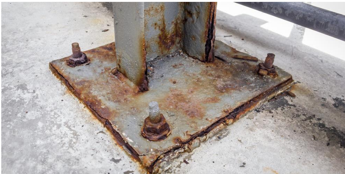
Slika 5.24. Korozija u procijepu kod čeličnog stupa [47]
