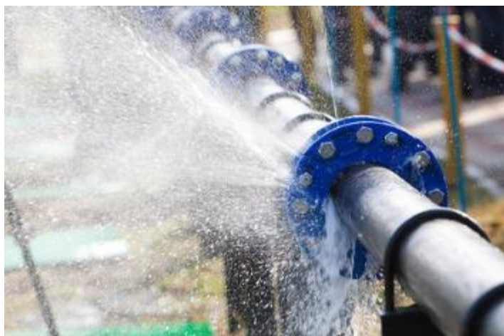
Slika 4.2. Oštećenje cjevovoda zbog tlačnog udara
