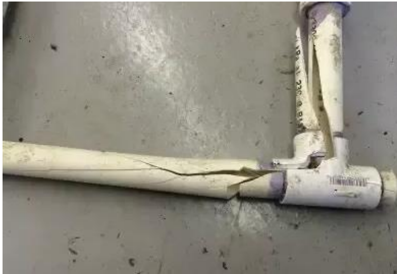
Slika 4.3. Puknuće cijevi zbog smrzavanja vode
