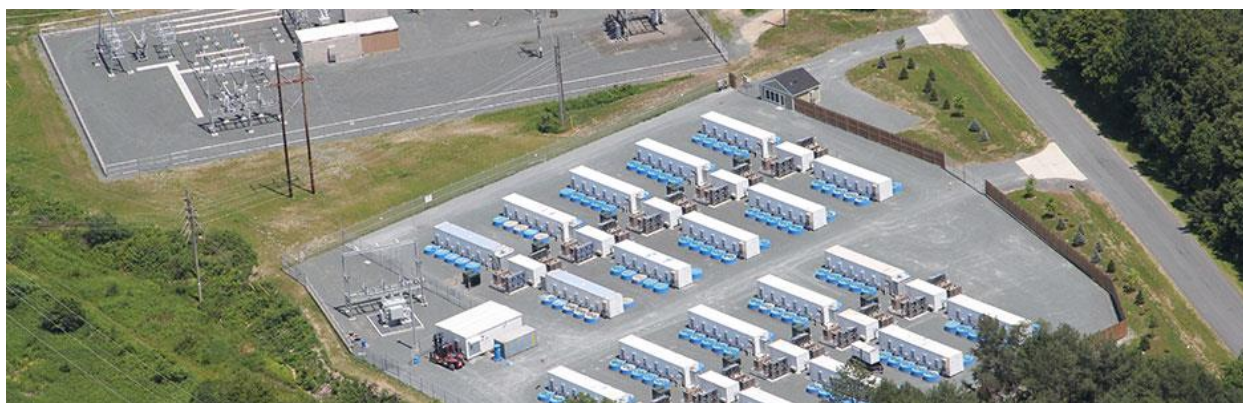
Slika 3.4. Postrojenje u Stephentown, New York (NY), SAD [27]
