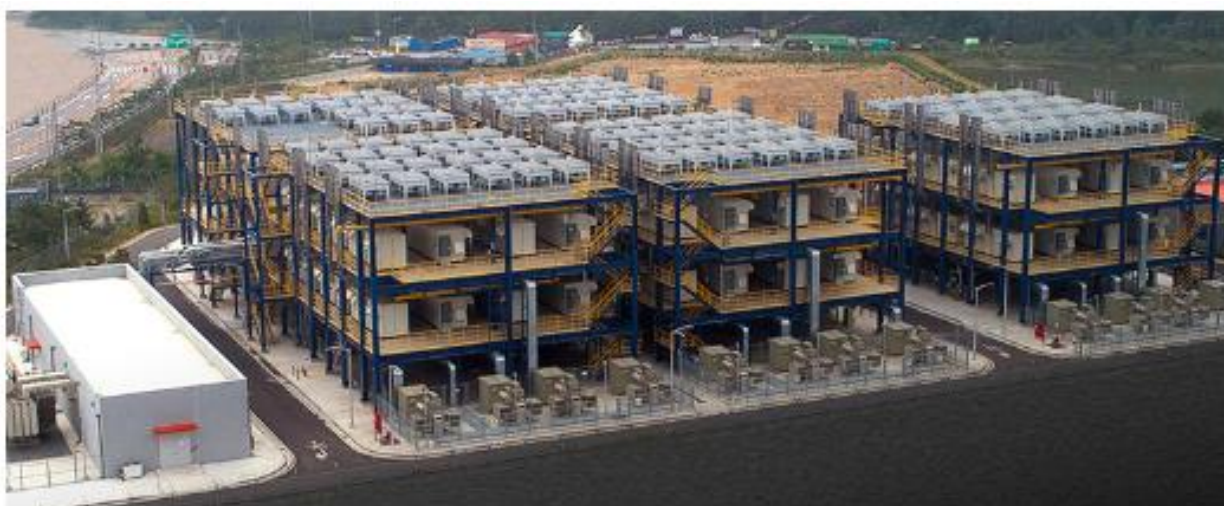
Slika 6.4. Najveće postrojenje sa gorivim člancima - Južna Koreja [31]
