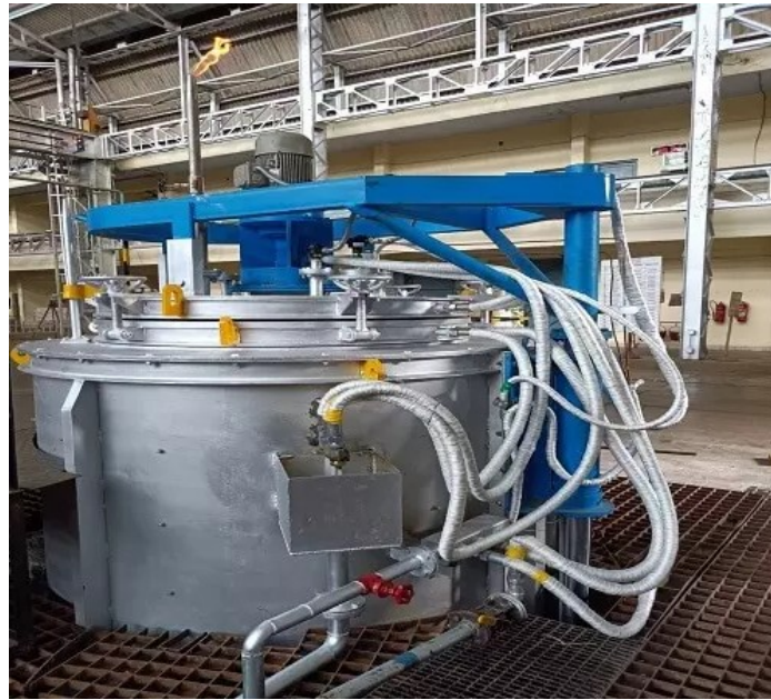
Slika 6.3. Cirkulacijska peć (eng. Pit Furnace) [15]
