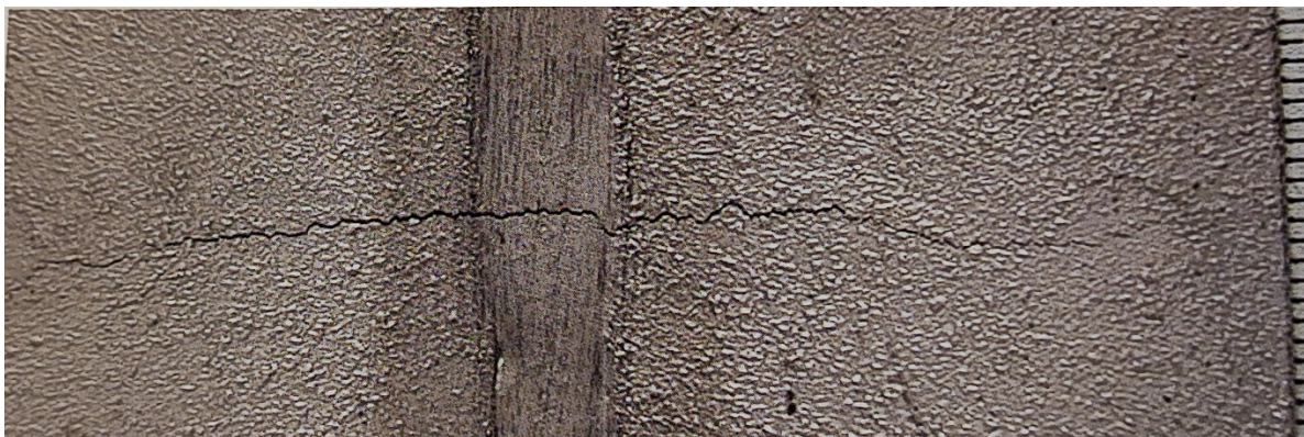
Slika 3.2. Poprečna pukotina u zavaru, ZUT-u i osnovnom materijalu [5]
