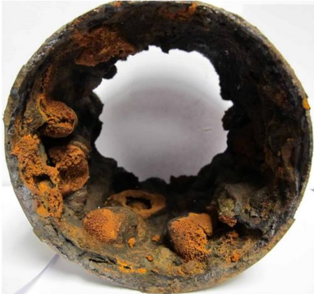
Slika 2.18. Biološka korozija u cijevi [7]
