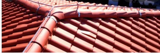
Slika 3.8. Gromobranska instalacija na krovu zgrade
