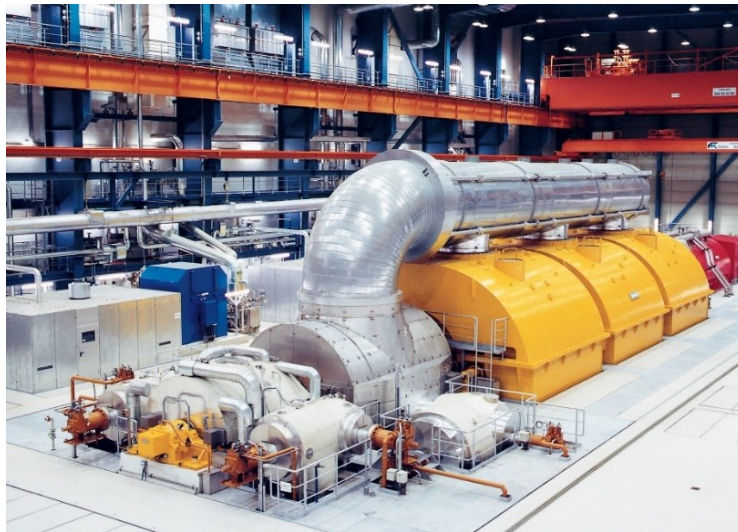
Slika 2: Turbogenerator snage 500MW [2]
