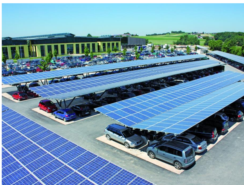
Slika 3.10. Primjena solarnih panela
