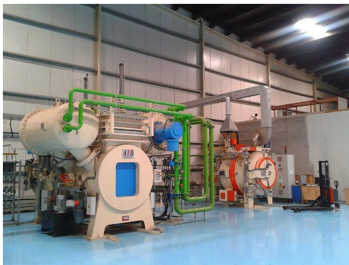
Slika 3.9. - Moderno postrojenje za pougličavanje u plinu [19]
