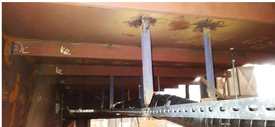
Figure 7 stud welded ventilation hangers behind cable trays Slika 7 Ovjesi ventilacije zavareni “nelson postupkom” vidljivi iza elektrotrase
