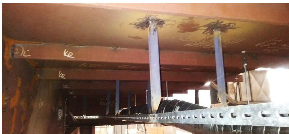
Figure 7 stud welded ventilation hangers behind cable trays Slika 7 Ovjesi ventilacije zavareni “nelson postupkom” vidljivi iza elektrotrase
