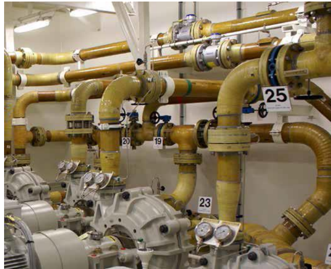
Slika 5. Prikazuje uporabu cjevovoda izrađenih polimera (smole) ojačanih staklenim vlaknima te se na istoj mogu vidjeti tlačni i usisni cjevovodi sisaljki morske vode na putničkom brodu
