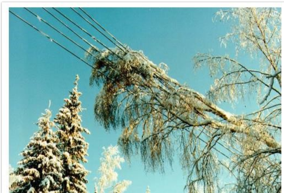
Slika 3.2.1. Vod s poluizoliranim vodičima s srušenom granom na vodiče dok je pod naponom [6]
