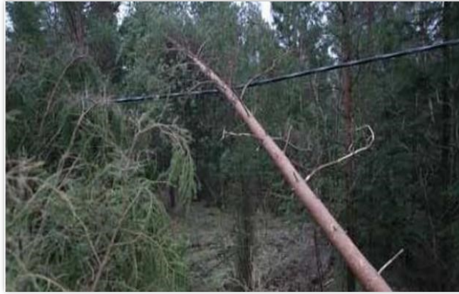
Slika 3.2.2. Vod s poluizoliranim vodičem i dalje u pogonu iako je stablo srušeno na njega, [6]
