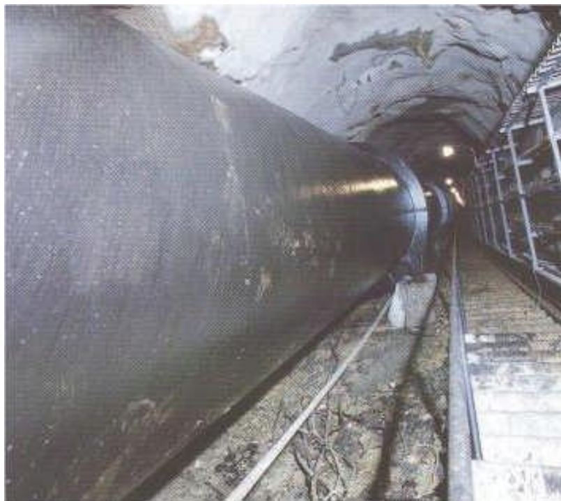
Slika 3.3. Tlačni cjevovod na Hidroelektrani Rijeka [24]
