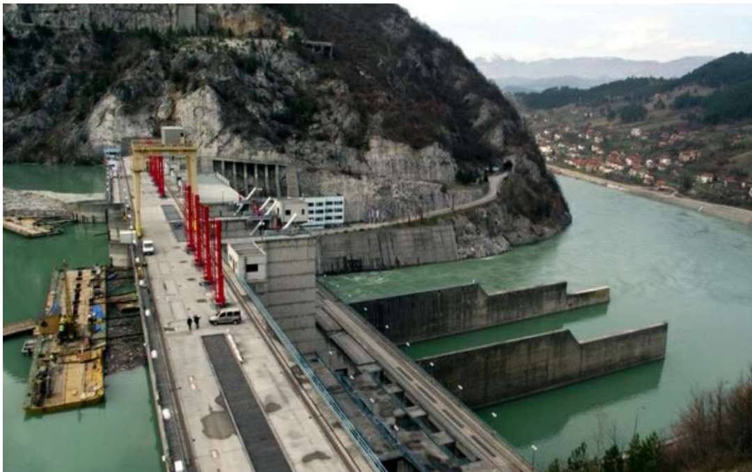
Slika 5.1. Hidroelektrana Zakučac (preuzeto sa: http://www.energypress.net/rekonstruirana-he-zakucac/ )
