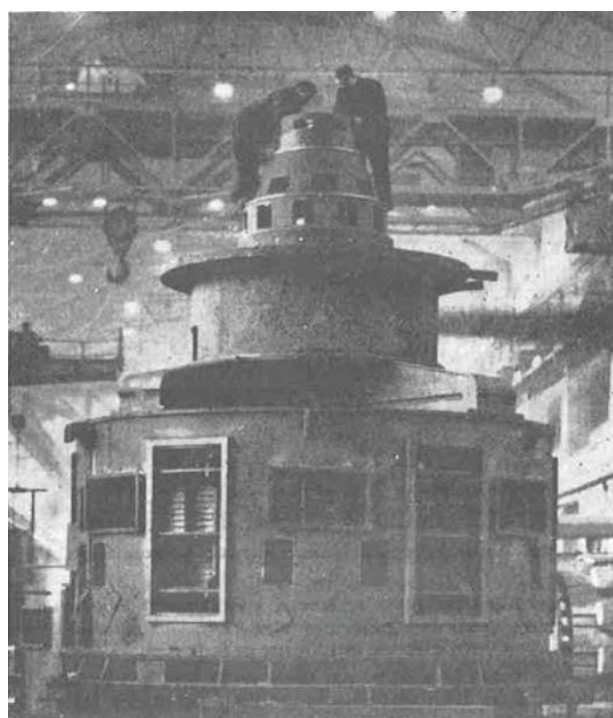
Slika 2.15. Hidrogenerator postavljen vertikalno s osovinom [4]
