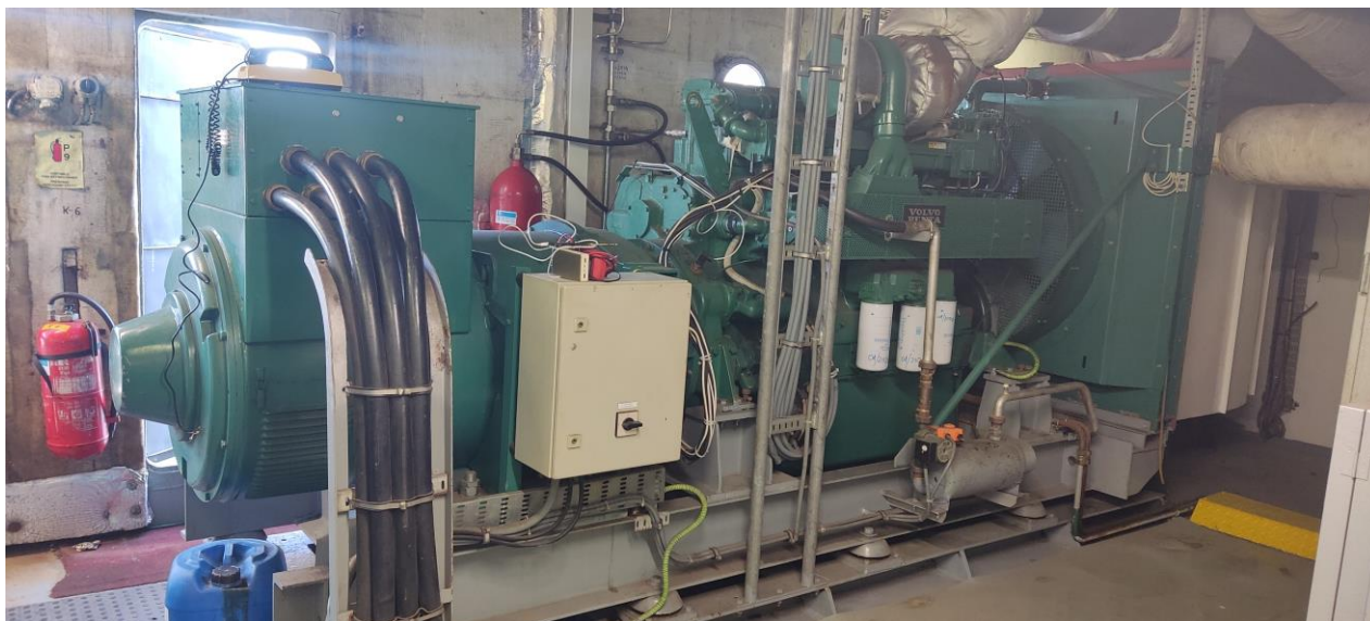
Slika 10.2. Generator za nuždu MT Marko Polo
