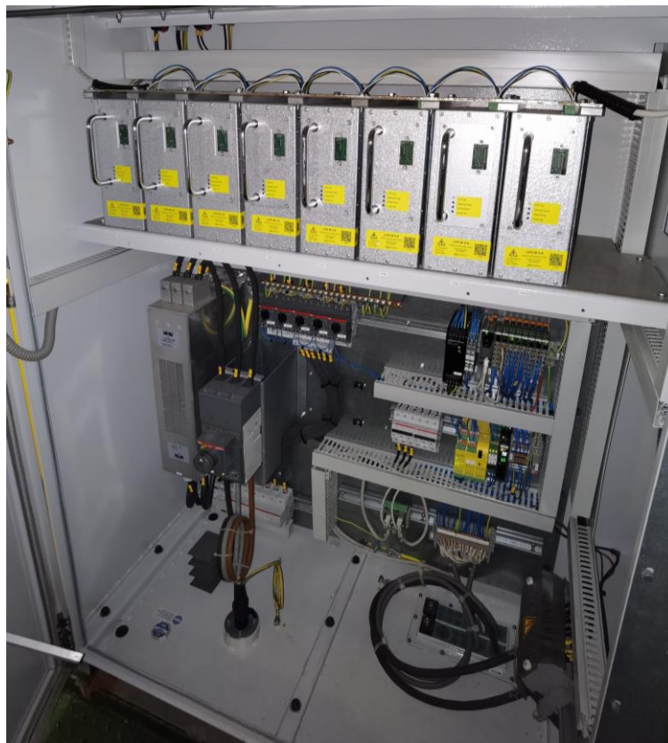
Slika 8.1. Upravljači zajedno s osiguračima i podatkovnim kabelima UV tretmana za balastne vode
