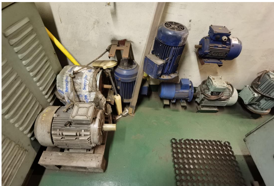
Slika 6.4. Rezervni elektromotori na brodu (za razne uređaje)
