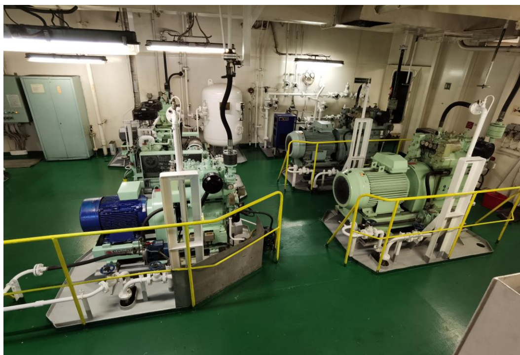
Slika 6.5. Kompresori pogonjeni elektromotorima
