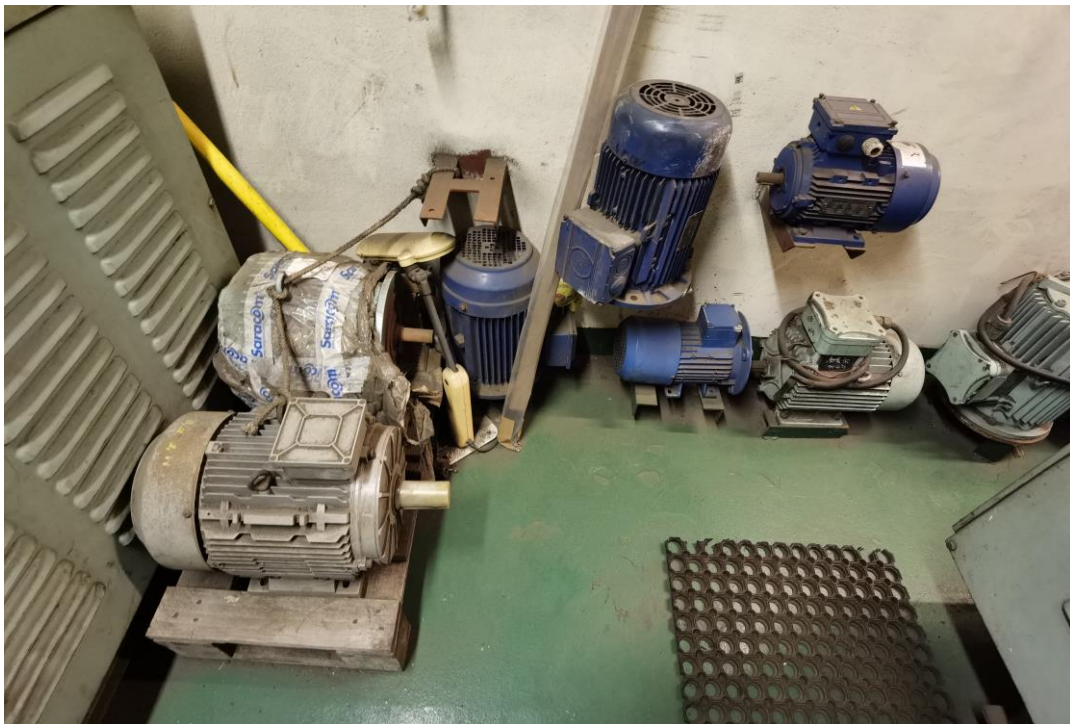
Slika 6.4. Rezervni elektromotori na brodu (za razne uređaje)
