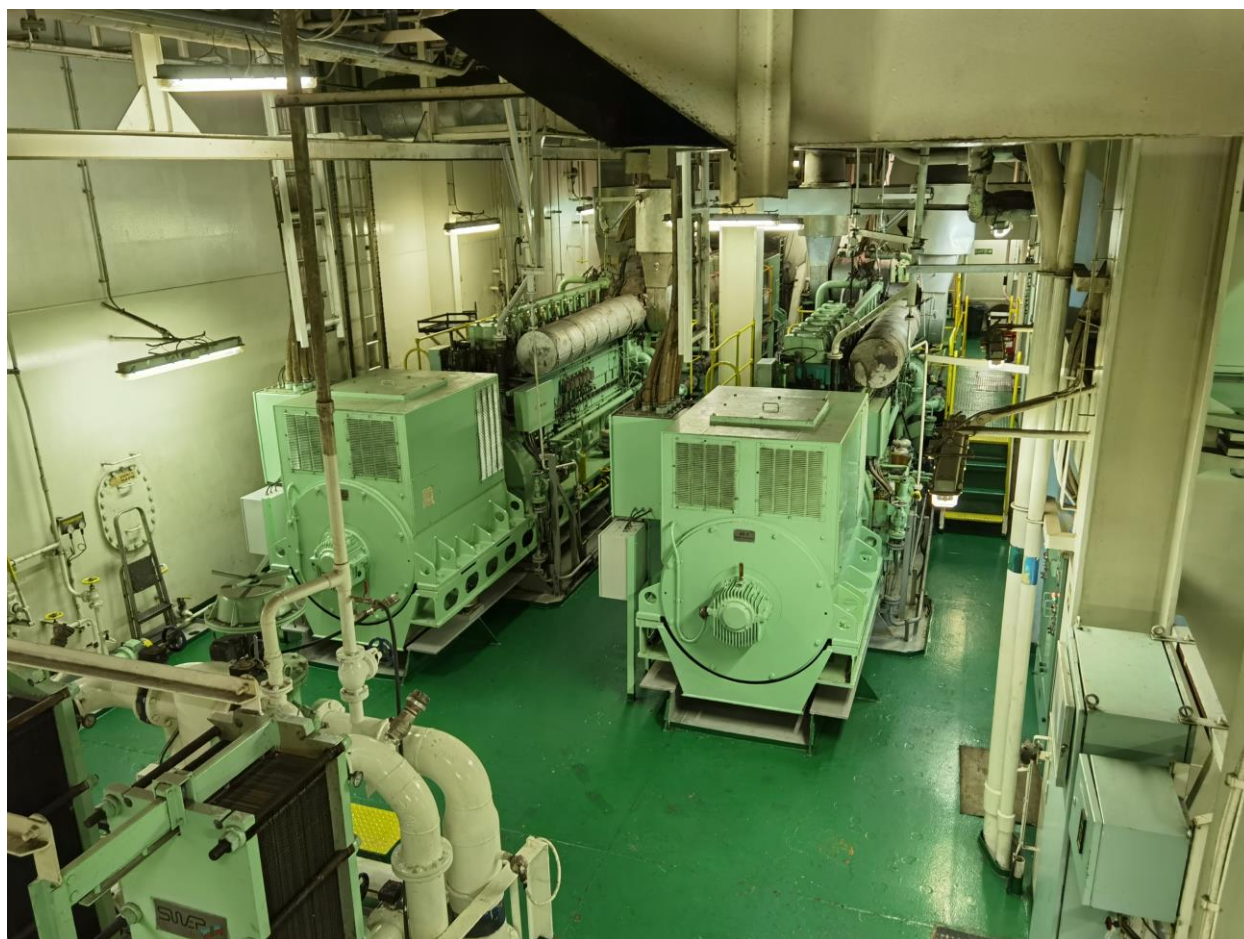
Slika 6.3. Generatori u strojarnici
