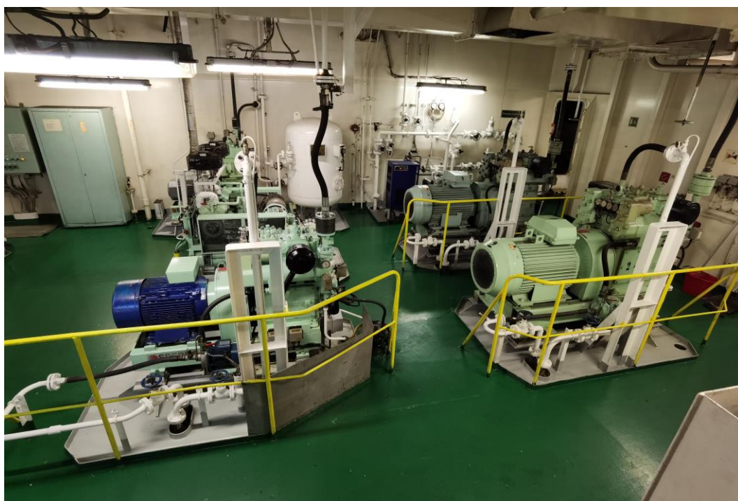
Slika 6.5. Kompresori pogonjeni elektromotorima
