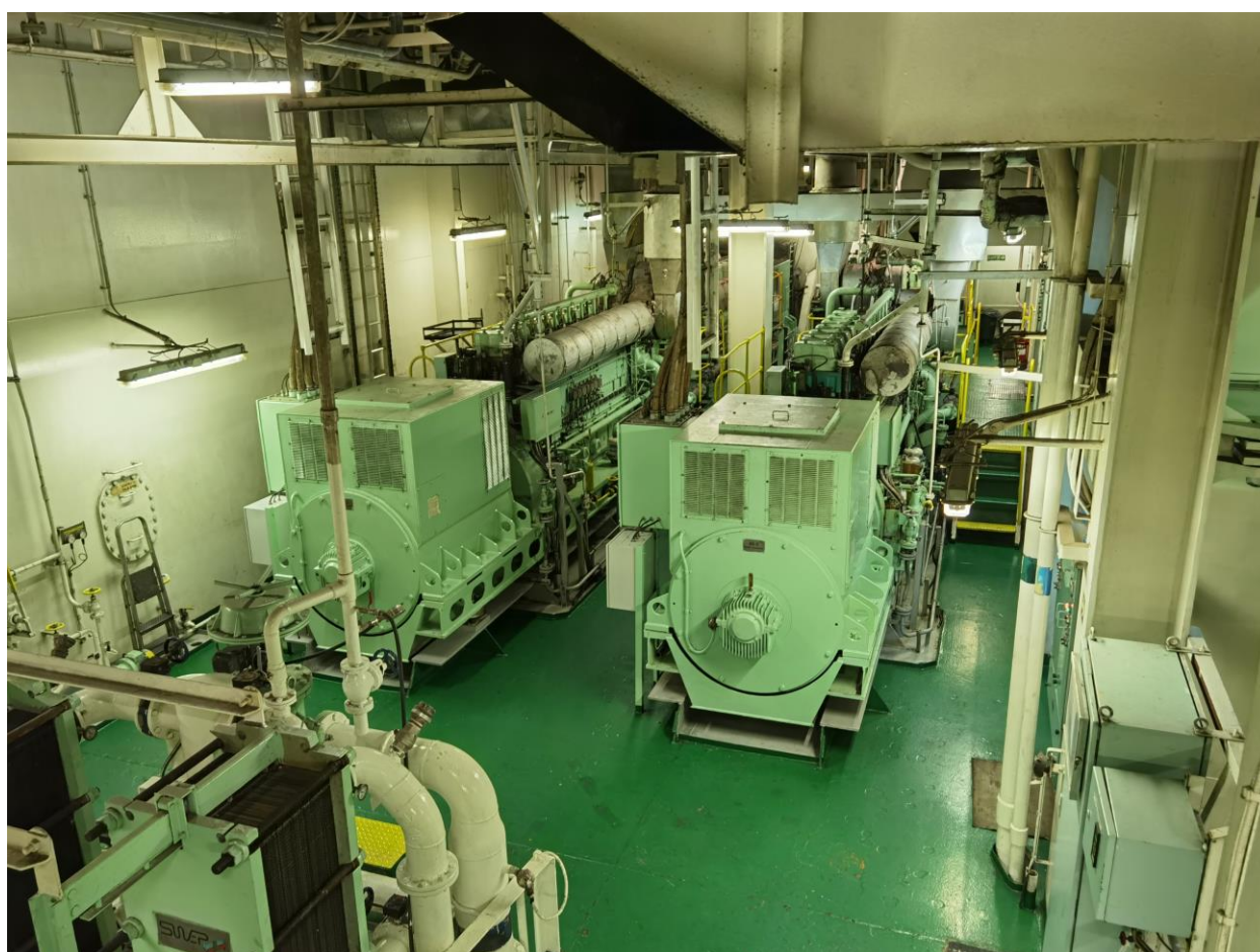
Slika 6.3. Generatori u strojarnici
