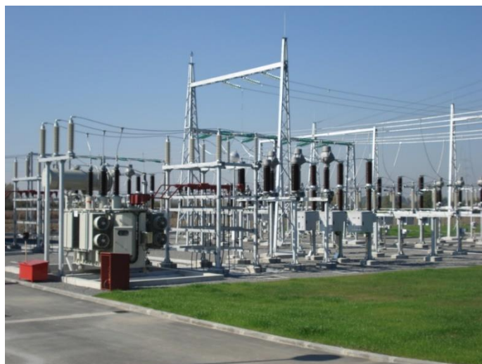
Slika 2.14. Vanjska izvedba trafostanice 110/35 kV Pokuplje [19]
