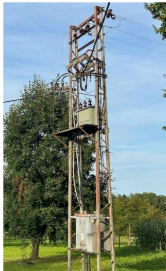
Slika 2.13. Stupna transformatorska stanica
