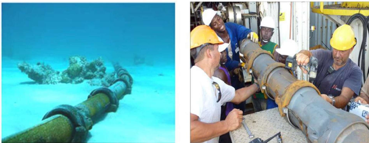
Slika 7.7: Kabel s ljuskom od lijevanog željeza i instalacija ljuske od lijevanog željeza na kabel (uz nepoštivanje današnjih sigurnosnih mjera) [1]
