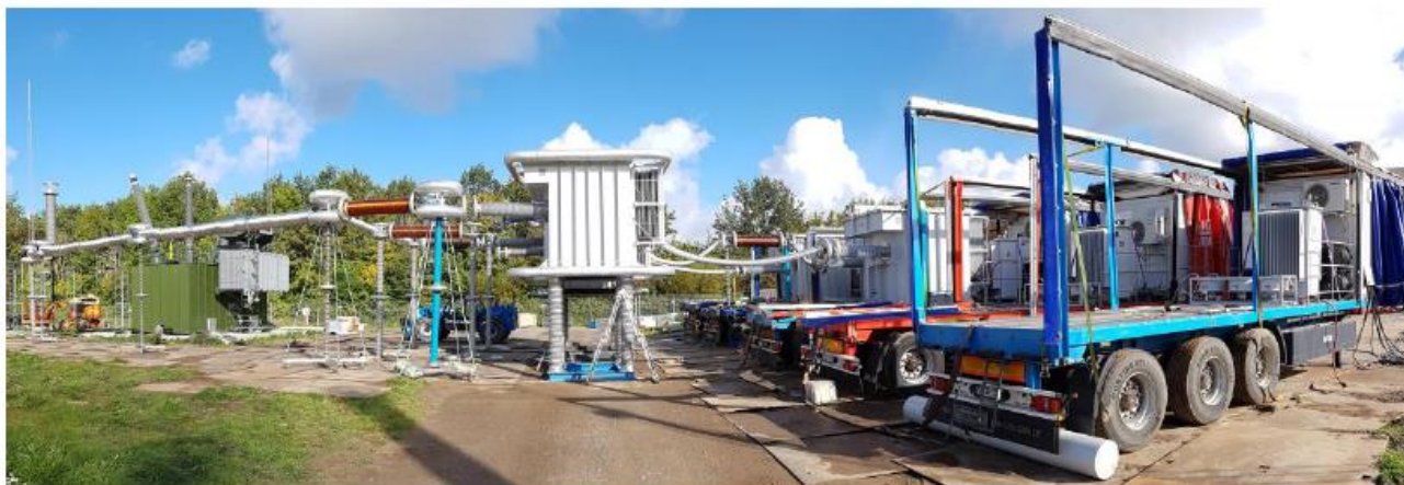
Slika 6.1. Ispitni sustav za ispitivanje dugih AC 400kV kabela [10]
