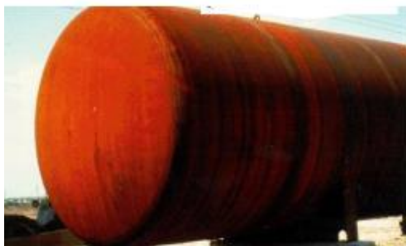
Slika 3.2 Opća korozija čeličnog spremnika [8]
