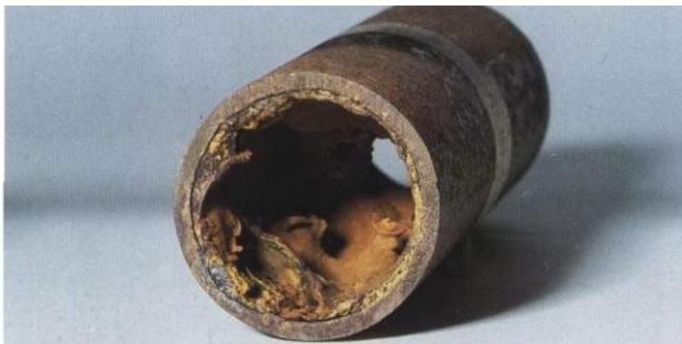
Slika 3.14 Bakterijska korozija ugljičnog čelika [8]
