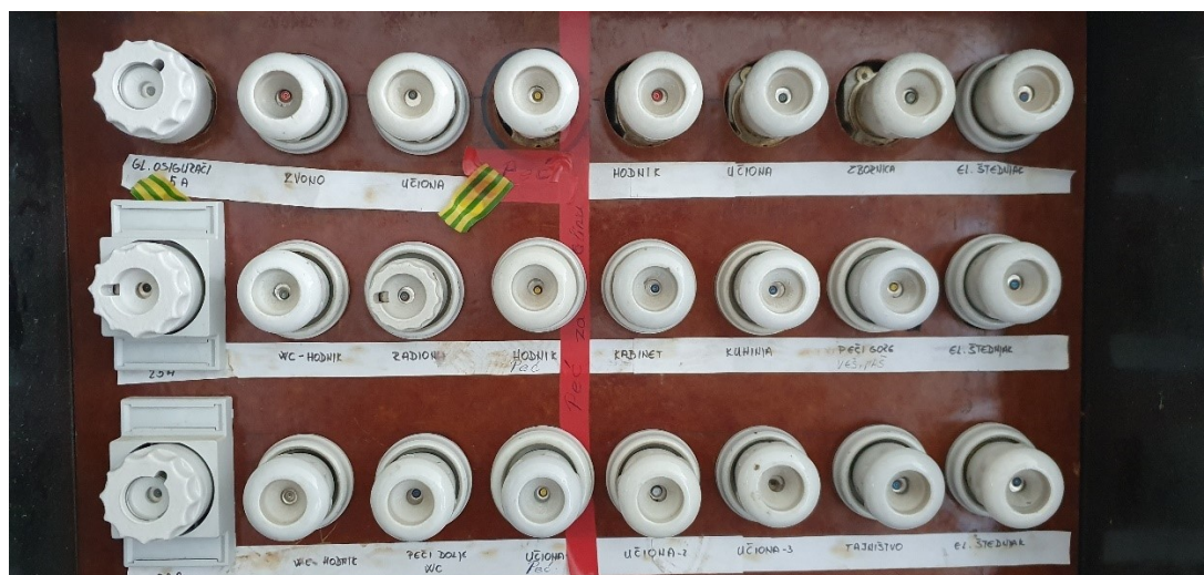
Slika 5.9 Rastalni osigurači DII ugrađeni unutar razvodnog ormara
