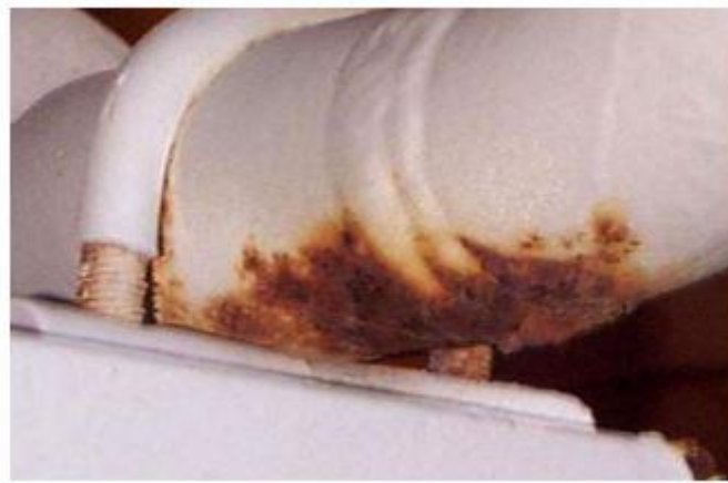
Slika 2.17.: Primjer oštećenja metala uslijed korozije u procjepu [3]
