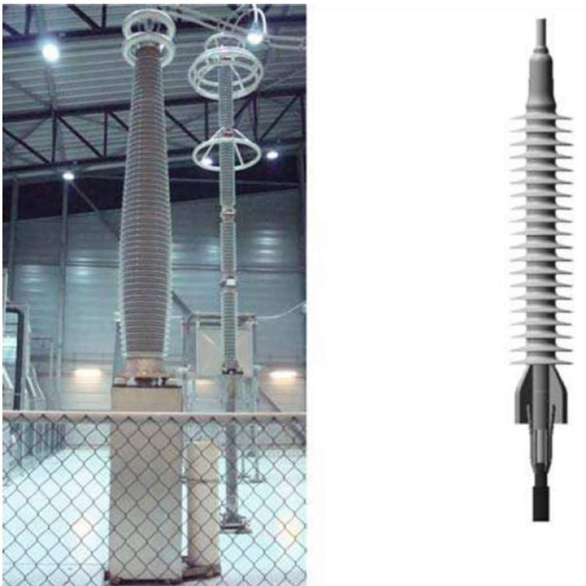
Slika 4.22. Unutrašnji priključci za HVDC kabele, masom impregnirane kabele (lijevo) i ekstrudirane kabele (desno). Mali cilindar za spremnik ulja je pričvršćen za postolje lijevog priključka [13]
