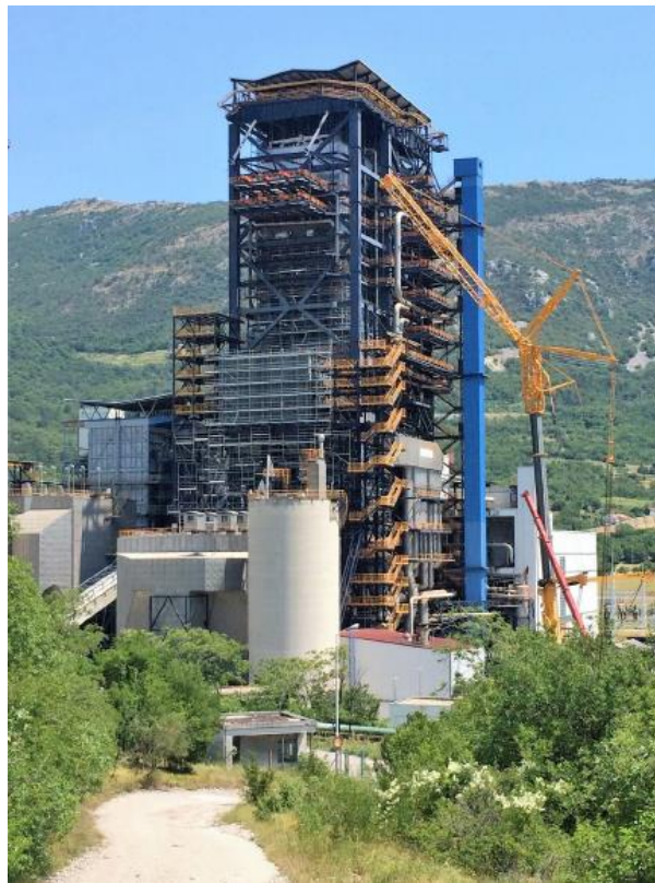
Slika 13. Kotlovsko postrojenje bloka 2 [5]
