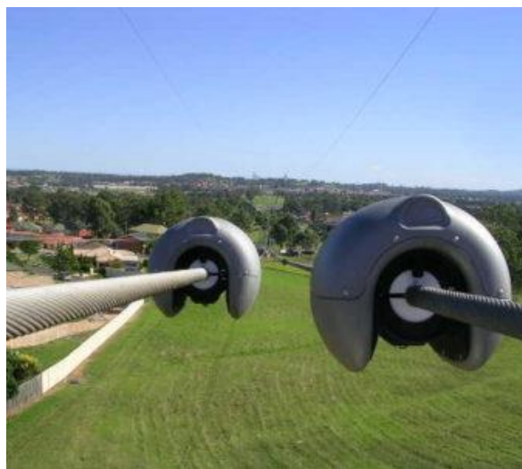
Slika 6.3. OTLM uređaji montirani na dalekovodu [46]
