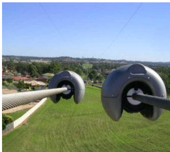
Slika 6.3. OTLM uređaji montirani na dalekovodu [46]
