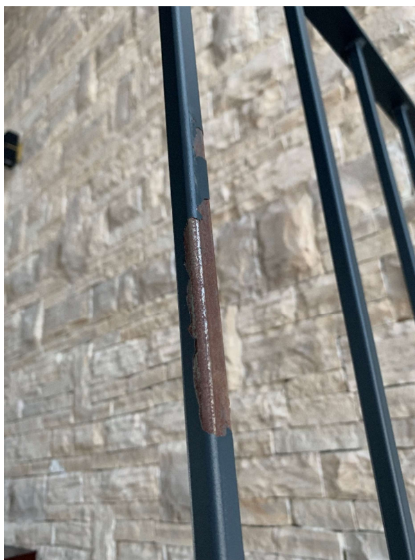
Slika 6.18: Korozija kod zaštite plastifikacije
