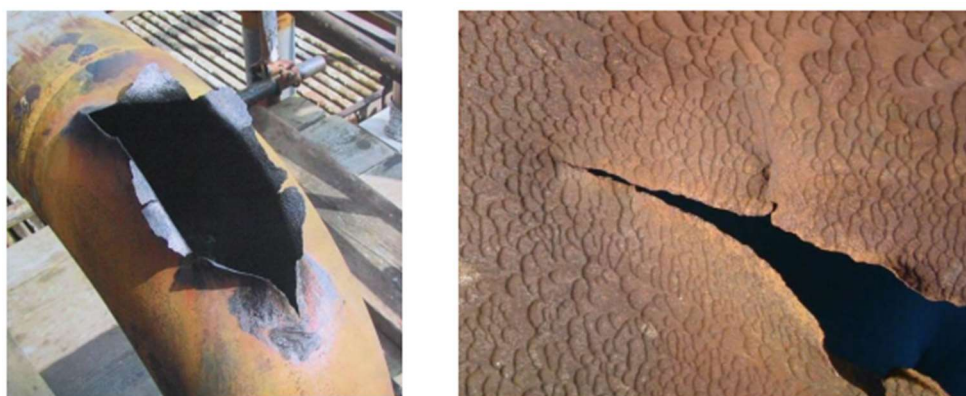
Slika 4.10: Erozijsko oštećenje cjevovoda za transport nafte [10]
