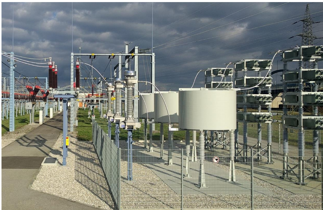
Slika 16. Primjer MSCDn (kondenzatorska baterija i prigušnice) nazivne snage 70 Mvar ugrađene na 115 kV
