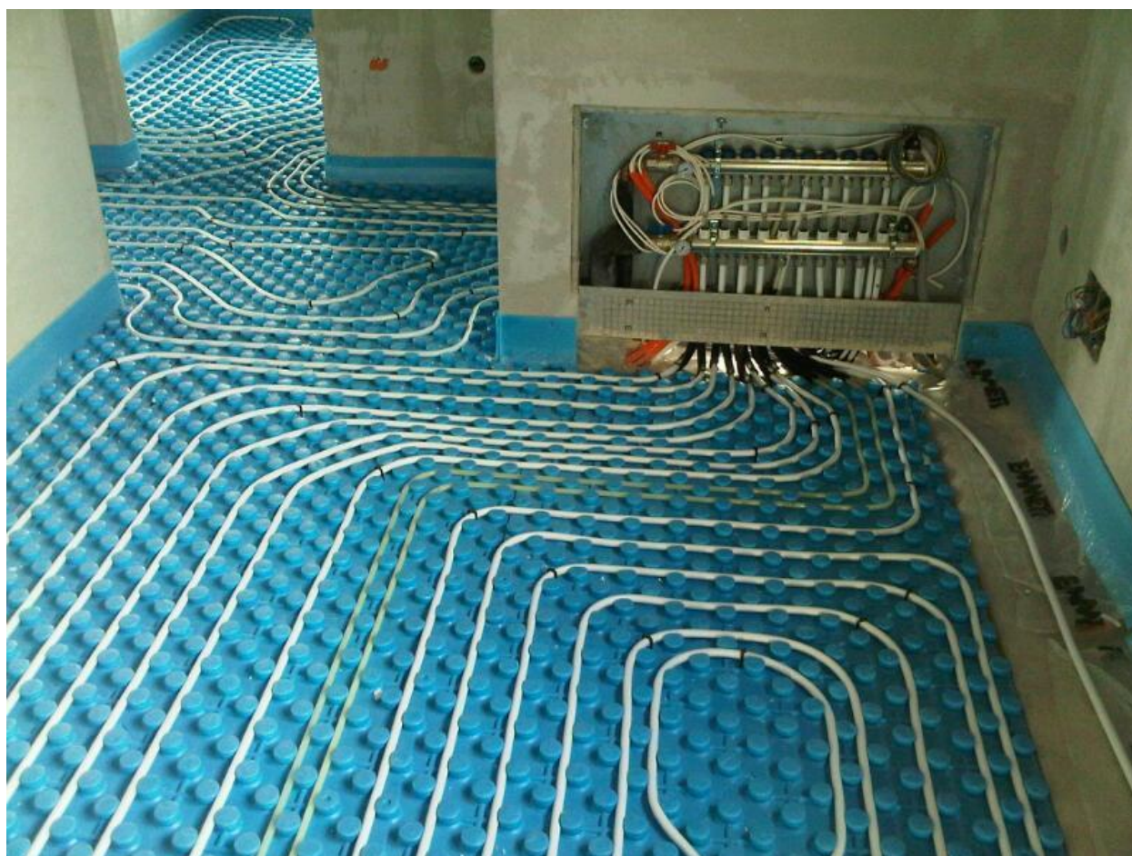
Slika 3.5. Instalacija podnog grijanja s razvodnim ormarićem [10]
