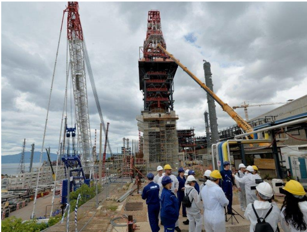
Slika 11 - Postrojenje za obradu teških ostataka[6]
