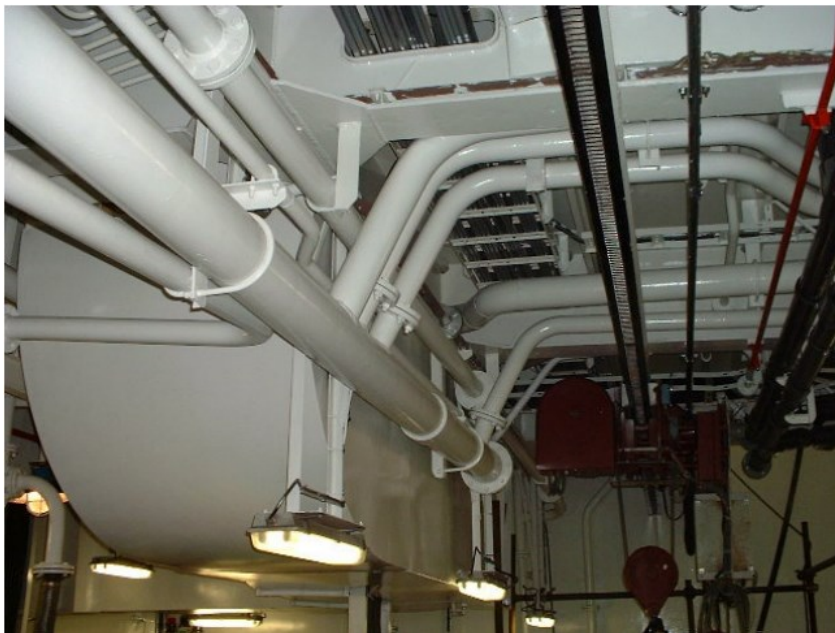
Slika 3.7. Detalj smještaja cjevovoda u strojarnici [11]
