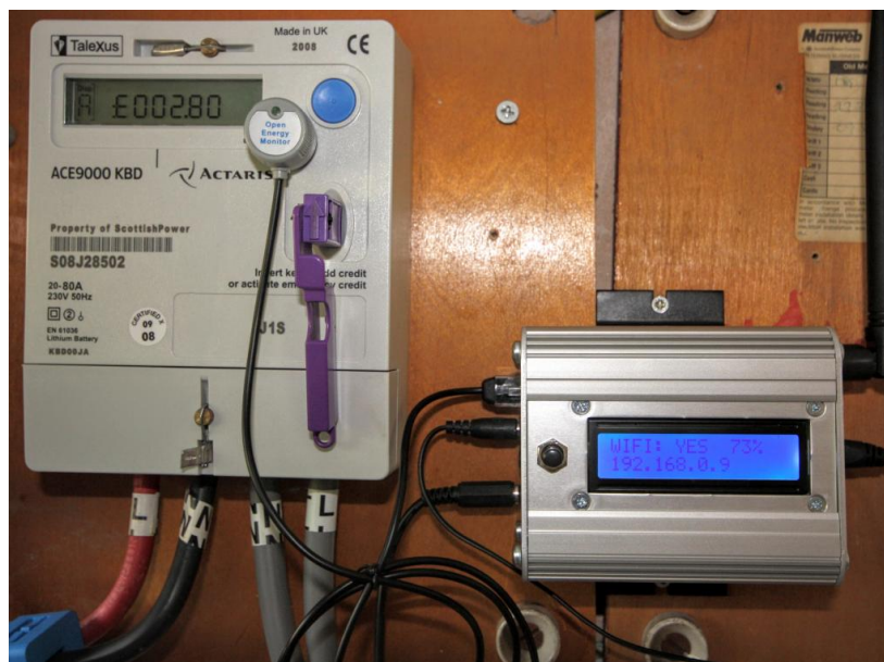
Slika 5.3 Instalacija OpenEnergyMonitor nadodatka na kućni brojač.
