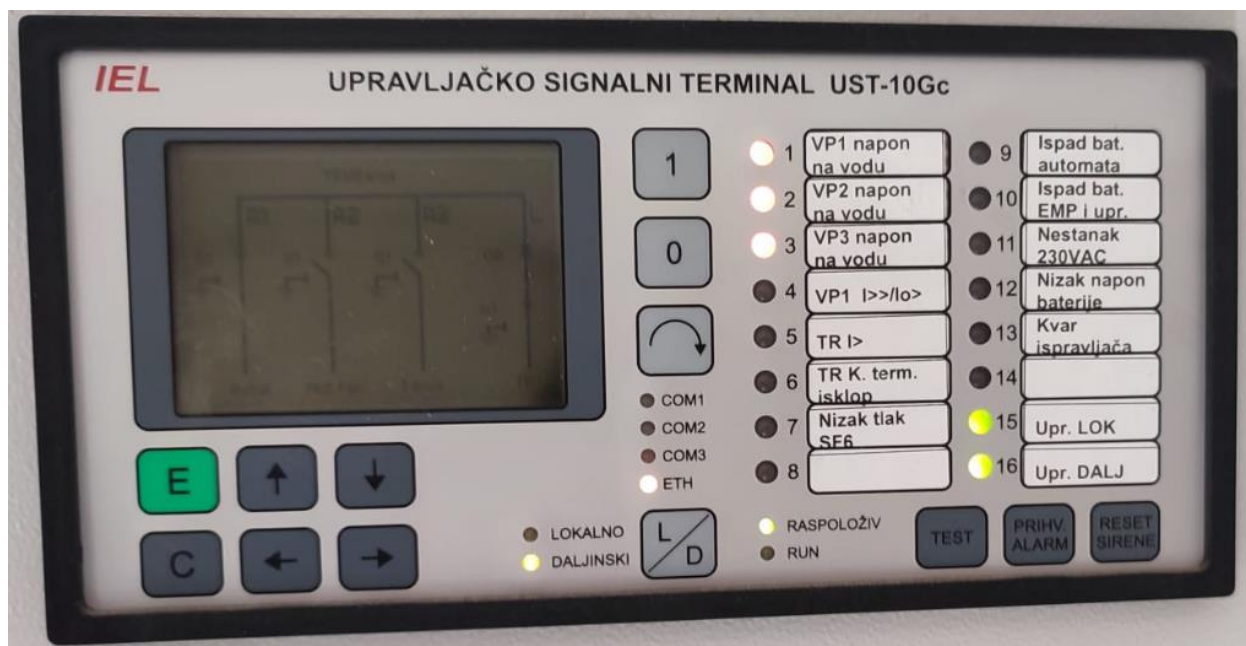
Slika 4.3. Zaslun upravljačkog signalnog terminala - daljinsko upravljanje
