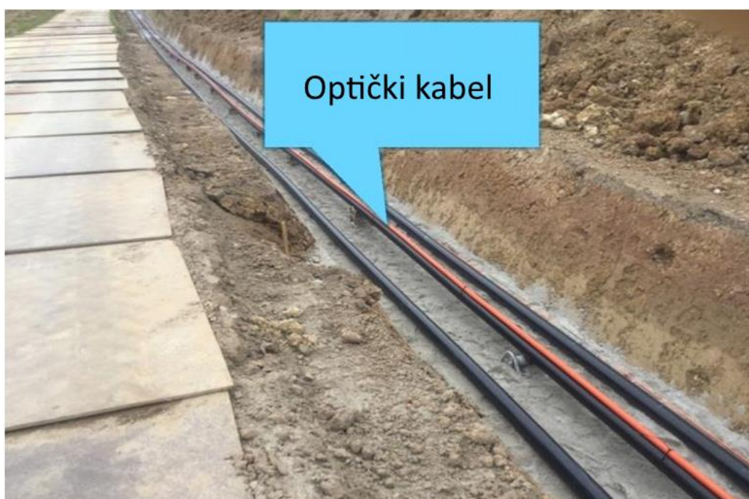
Slika 3.3 Optički kabel pored kabela za prijenos električne energije [20]
