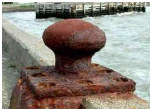
Slika 3.2 Opća korozija na metalu [6]
