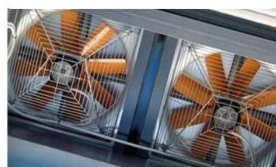
Ventilacija na stropu
