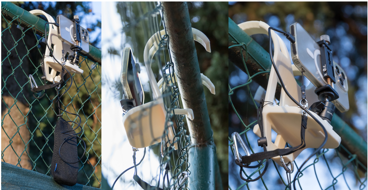
Slika 7.3 Nosač montiran na poprečnu cijev ograde igrališta
