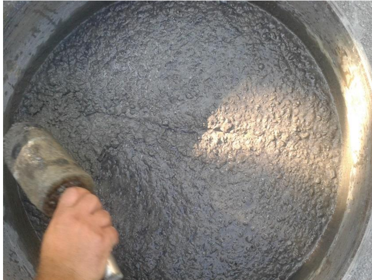
Slika 32 Bojanje svježeg betona i isplivavanje mješavine na površinu
