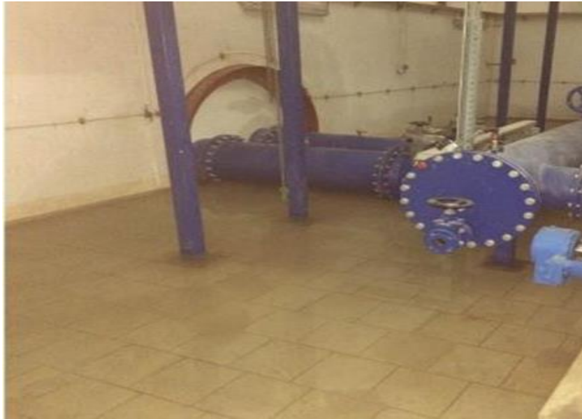
Slika 2.11. Cijevi na ulazu u crpnu stanicu
