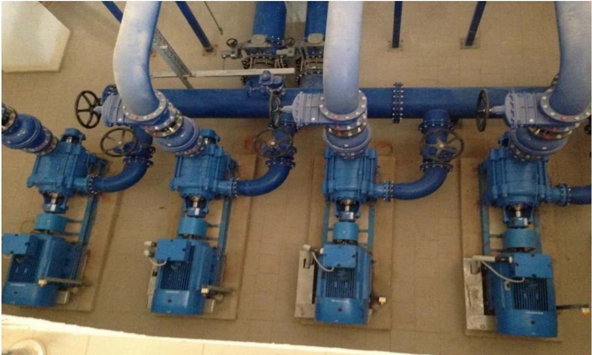
Slika 2.5. Četiri visokotlačne centrifugalne pumpe
