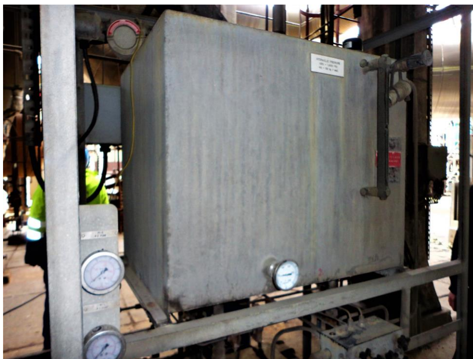
Slika 3-7 Spremnik ulja hidrauličkog agregata
