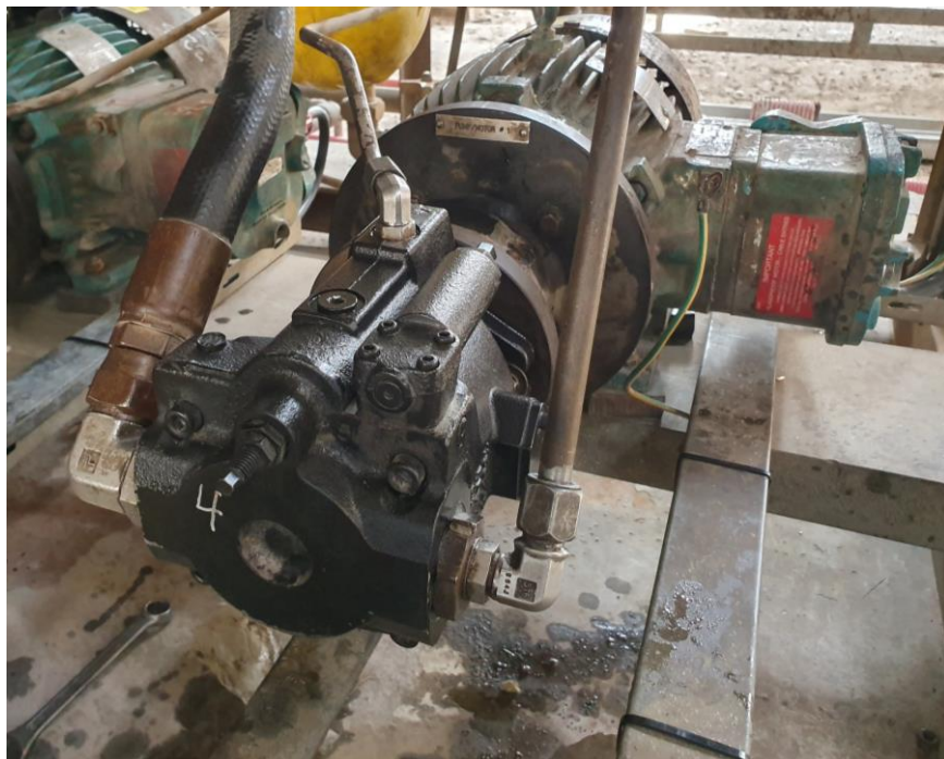
Slika 4-1 Hidraulička pumpa i elektromotor
