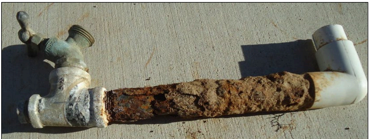
Slika 5.4. Galvanska korozija pocinčane čelične cijevi [41]
