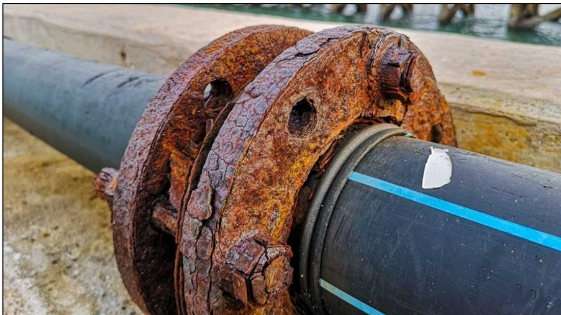
Slika 2.2. Korozija spoja dviju PEHD (alkaten) cijevi [7]
