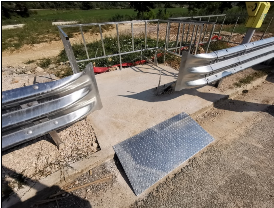
Slika 6.16. Pocinčane odbojne i zaštitne ograde te pristupni limovi na SOS proširenju [11]
