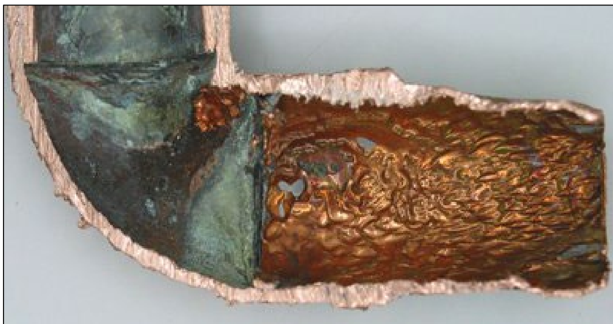
Slika 5.19. Erozijska korozija bakrene cijevi [51]
