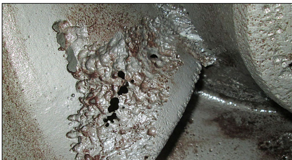
Slika 5.21. Kavitacijska korozija rotora pumpe [53]
