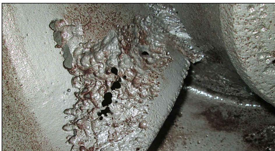
Slika 5.21. Kavitacijska korozija rotora pumpe [53]
