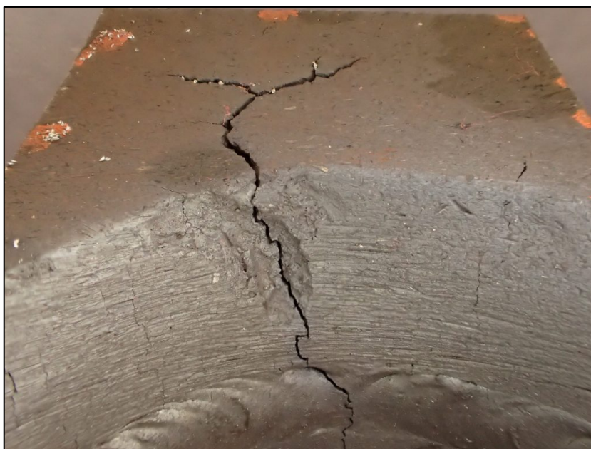
Slika 5.25. Oštećenje napetosnom korozijom pored zavora [56]
