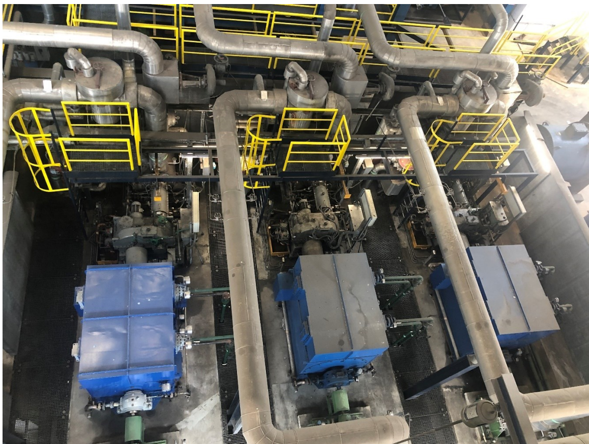
Slika 6.1. Elektromotori napojnih pumpi svaki snage 4100 kW
