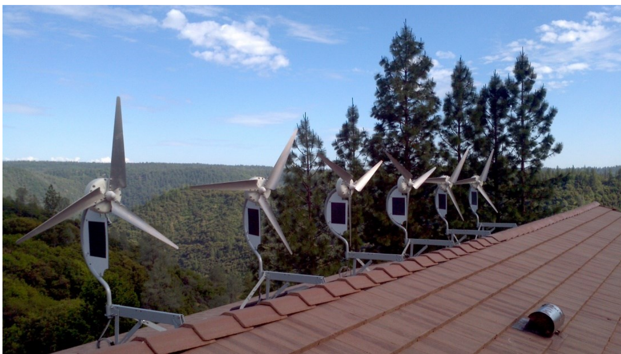
Slika 3.4. Vjetroturbine na krovu kuće
