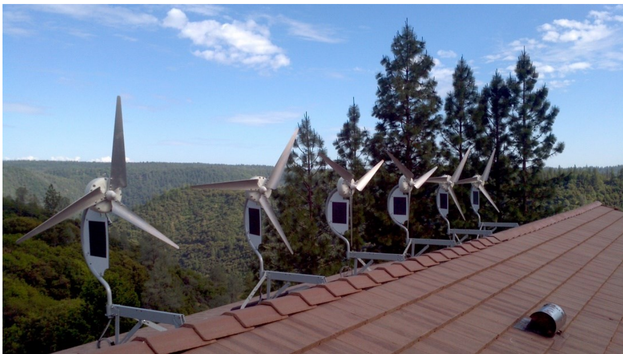
Slika 3.4. Vjetroturbine na krovu kuće
